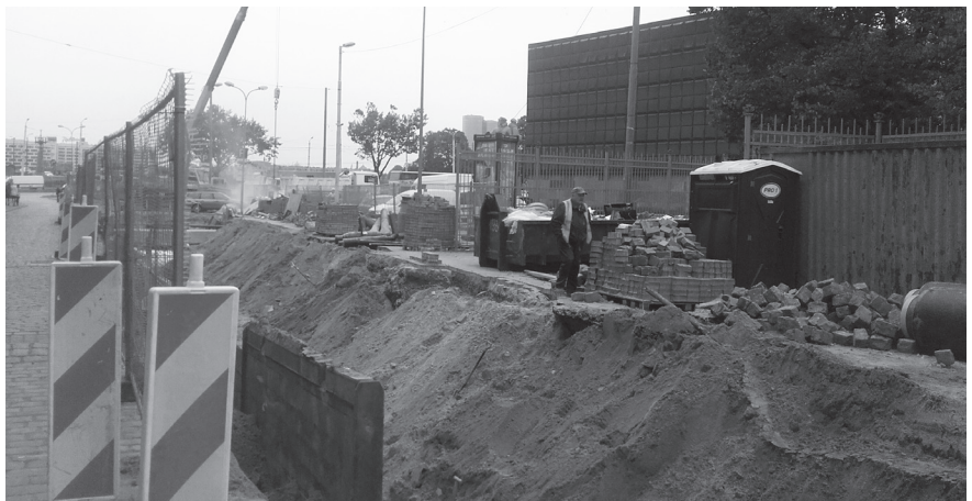
Septembrī Grēcinieku ielā blakus muzeja ēkai sākās siltumtrases pārvietošanas darbi. Jaunajai siltumtrasei būs pievads Nākotnes Namam
